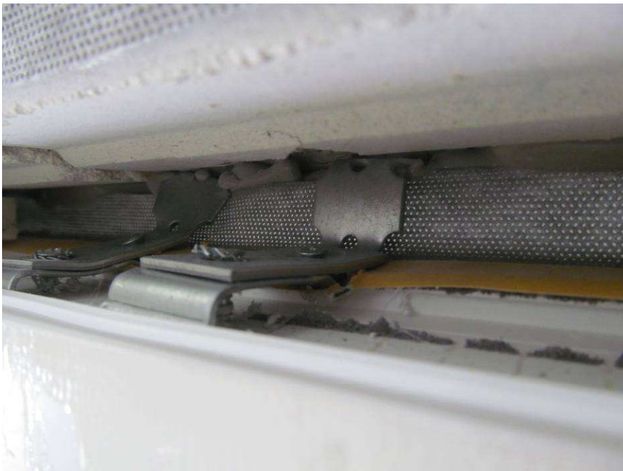
Bild 22 Zustand der Befestigung mit teilweise leichten Verformungen nach der Stoßbelastung
