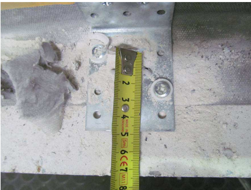
Bild 20 Zustand der Befestigung unten nach der Bauteilprüfung.
