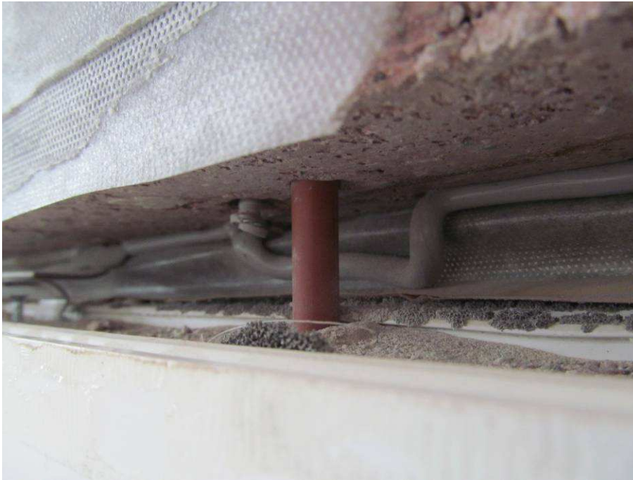
Bild 21 Zustand der Befestigung oben nach der Bauteilprüfung
